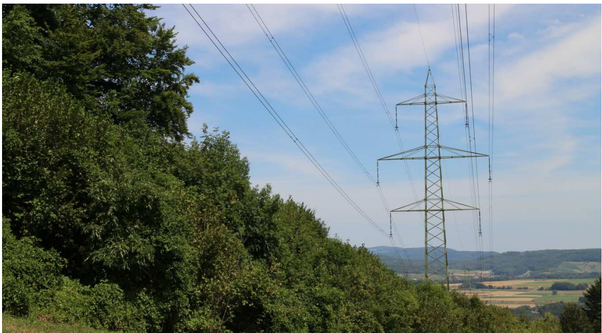
Bild 1: Starkstromleitung Beznau-Laufenburg in der Gemeinde Böttstein. (AWV)
